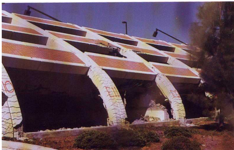
Figura 3.9 – Colapso de uma das alas do silo-auto [20].
