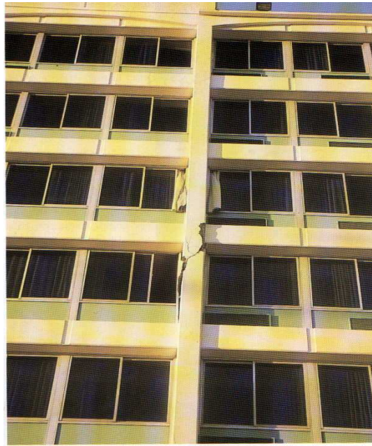
Figura 3.5 – Danos em pilares ao nível do 4º piso do edifício [20].
