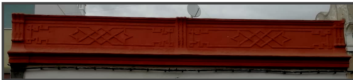
Figura 4.4 – Platibanda III (noivas em efeito de espelho) de casa em Luz de Tavira (foto: Margarida dos Santos).
