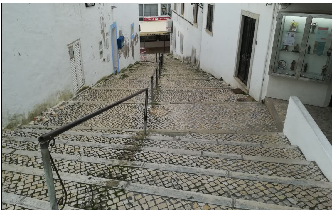
Figura 3.22 - Escadaria pública em calçada com dimensão irregular dos degraus
