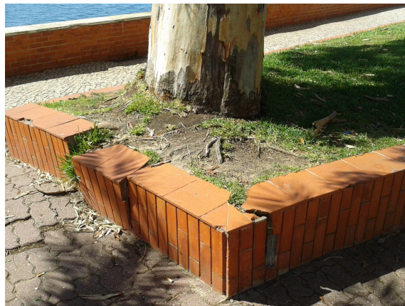
Fig.4.14 - Degradação dos muretes.
