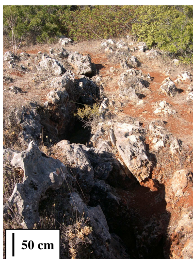
Fig. 3.55 – Fractura com alinhamento aproximadamente E-O, associada ao abatimento de cavidades cársticas subterrâneas; abertura com cerca de 50 cm de largura (perto da entrada do Algar dos Mouros).
