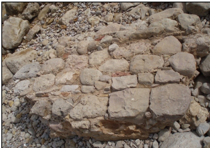
FIG. 139 Derrube 6 (D6). Mais um troço murário (I.E.M.).
