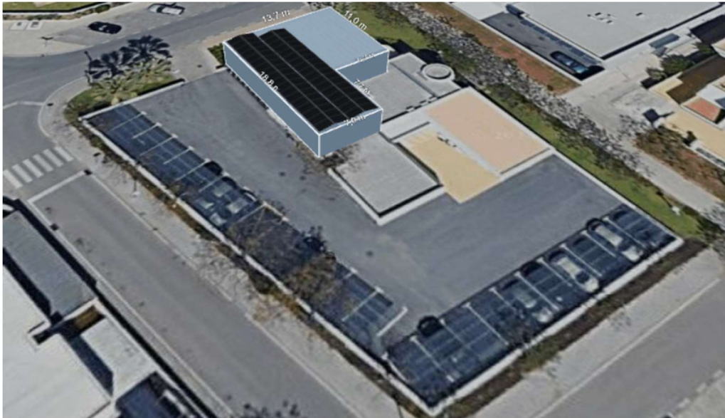
Figura 8 - Painéis fotovoltaicos instalados na cobertura.
