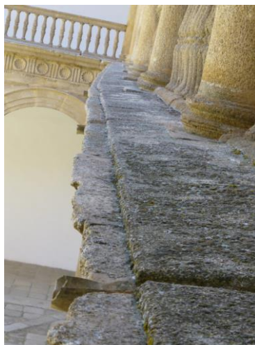
Figura 3. Pliegue en la base de la balastrada del claustro SW del segundo piso.
