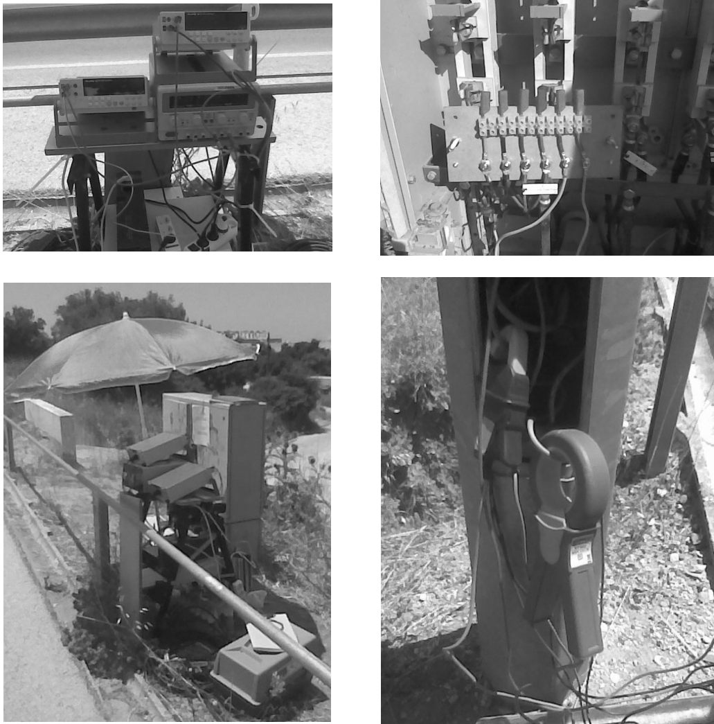
Figura 5.11: Fotografias da instalação utilizada no terreno para medir os parâmetros eléctricos duma rede IP em funcionamento.
