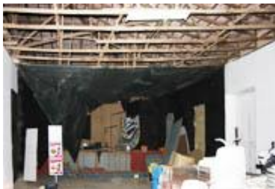
Figura 51 – O denominado «salão de festas» da Sociedade, no seu actual estado de degradação.
