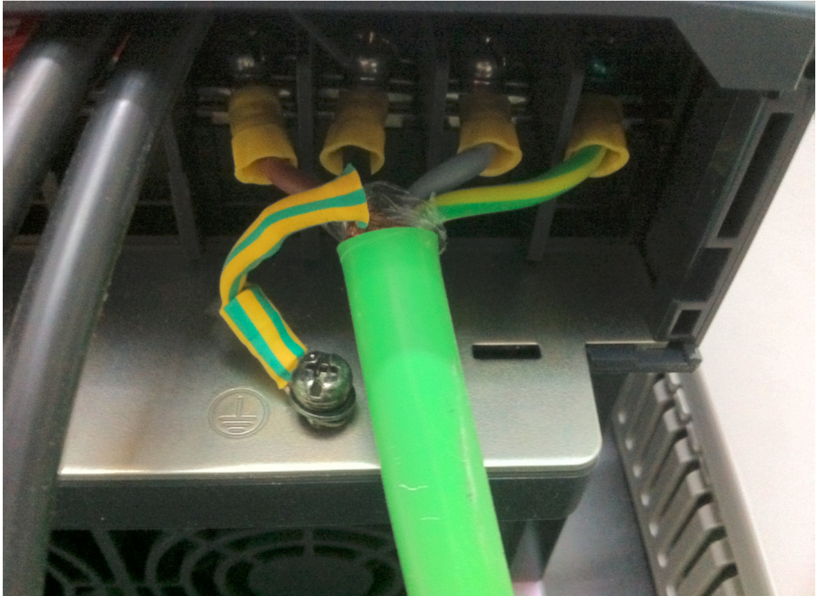
Figura 4-14 – Fotografia da ligação de potência de um Variador de Velocidade ATV312
