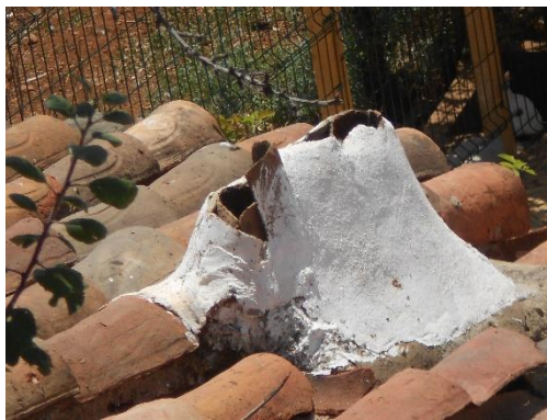
Figura 37 - Chaminé rudimentar, telhas tapadas com argamassa. Fotografia da autora.
