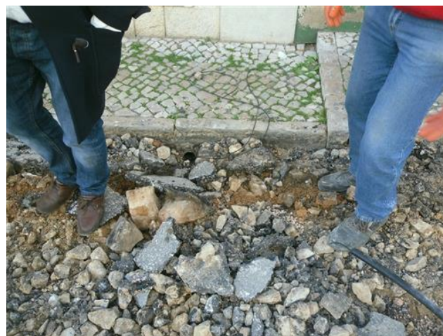
Figura 4.133 – Cabo elétrico danificado
