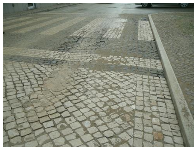
Figura 4.115 – Abatimento do pavimento
