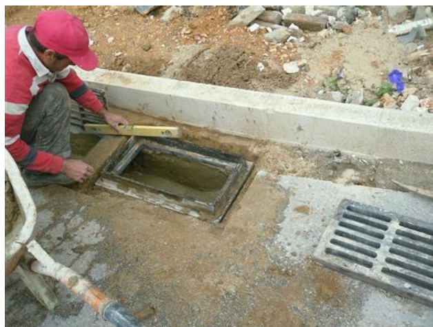
Figura 4.107 – Caixa de pluvial mexida
