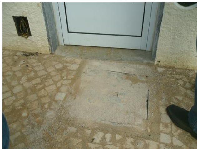
Figura 4.52 – Entrada de água
