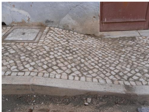
Figura 4.42 – Anomalia construtiva á porta da garagem
