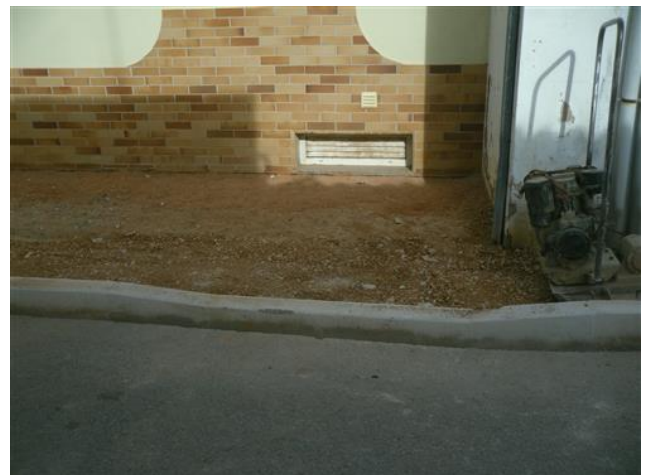
Figura 4.59 – Sistema de ventilação do edifício
