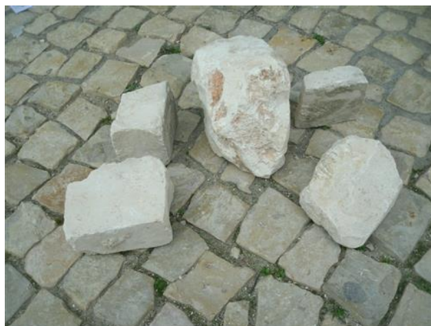
Figura 4.180 – Pedras da calçada irregulares
