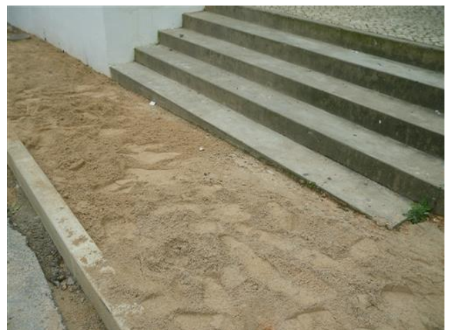
Figura 4.100 – Necessidade de remoção do degrau
