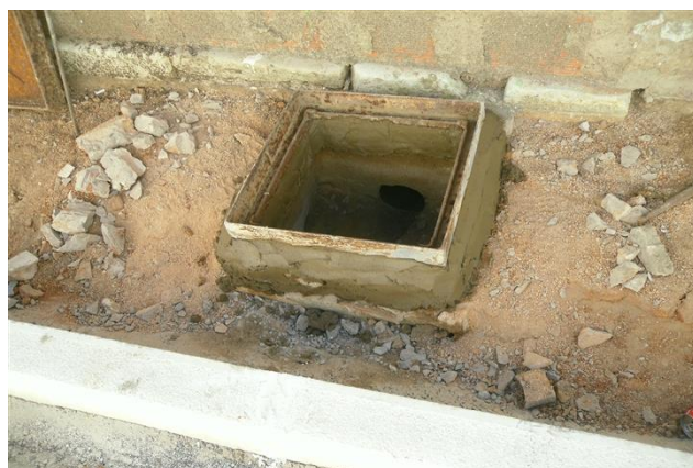
Figura 4.26 – Caixa de esgotos no passeio
