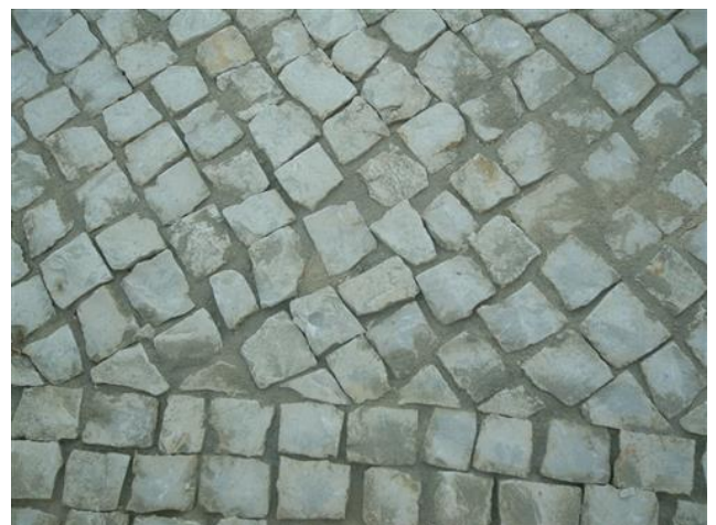
Figura 4.88 – Pedras da calçada irregulares
