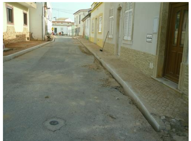
Figura 4.58 – Falta de confinamento do passeio
