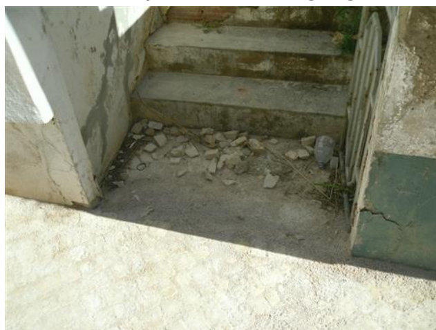
Figura 4.23 – Patamar da escada desnivelado
