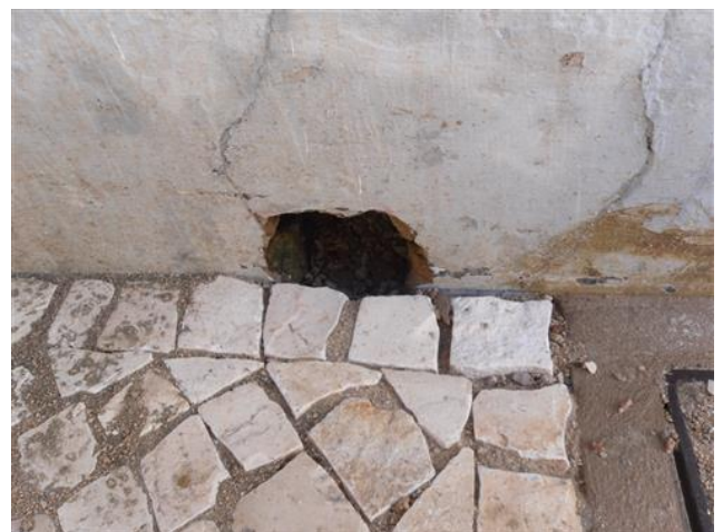
Figura 4.38 – Saída de pluvial obstruída
