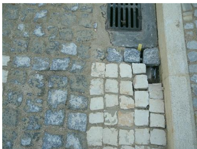
Figura 4.113 – Desagregação de material
