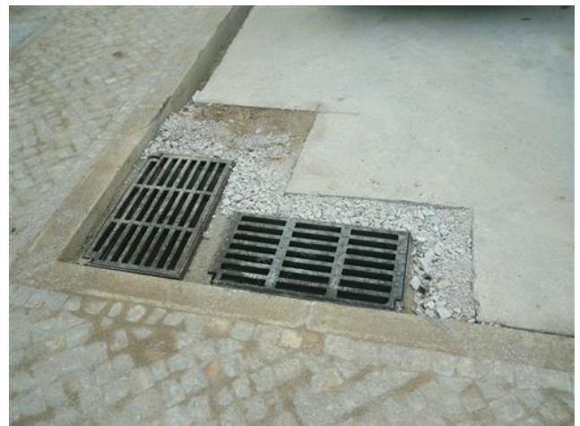
Figura 4.159 – Sistema de sumidouros operacional
