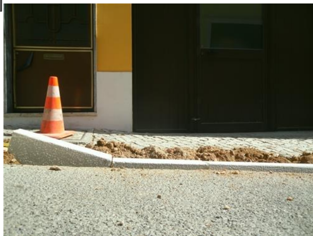
Figura 4.30 – Conflito no rebaixamento de lancil
