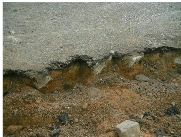
Figura 4.64 – Betuminoso por cima de calçada
