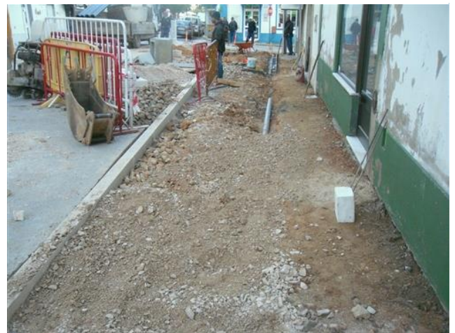
Figura 4.148 – Desvio de pluviais para a caleira
