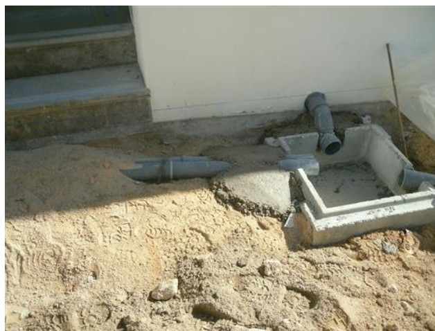
Figura 4.14 – Caixa de pluviais
