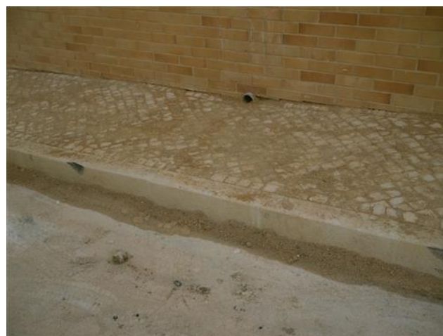
Figura 4.55 – Pluvial a descarregar no passeio
