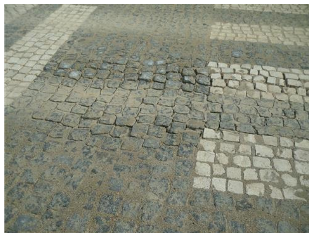
Figura 4.114 – Abatimento do pavimento
