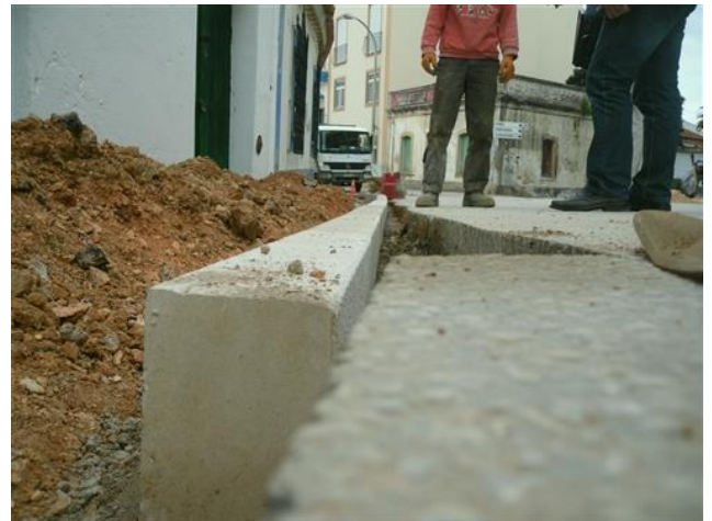
Figura 4.102 – Lancil quase soterrado
