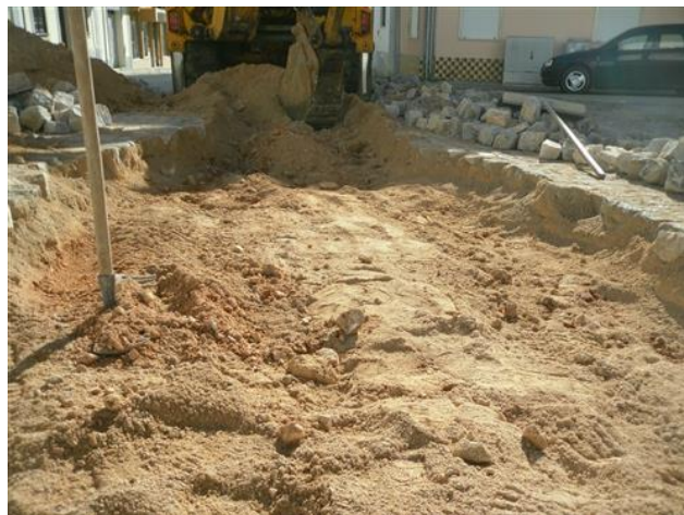
Figura 4.136 – Tentativa de reparação do abatimento
