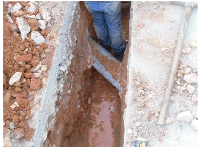
Figura 4.122 – Tubagem de abastecimento de água
