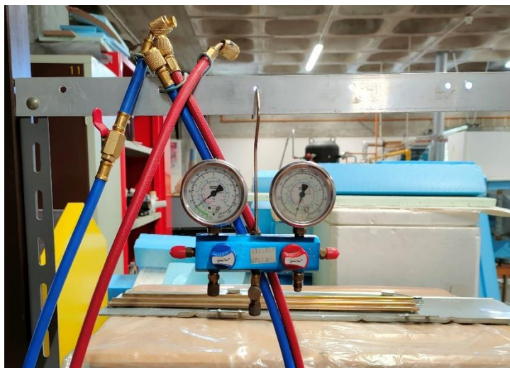
Figura 3.19 - Manómetros de pressão utilizados no carregamento do circuito
