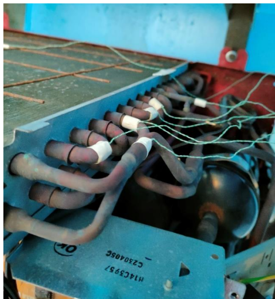
Figura 4.5 - Colocação dos termopares no permutador de calor da unidade exterior
