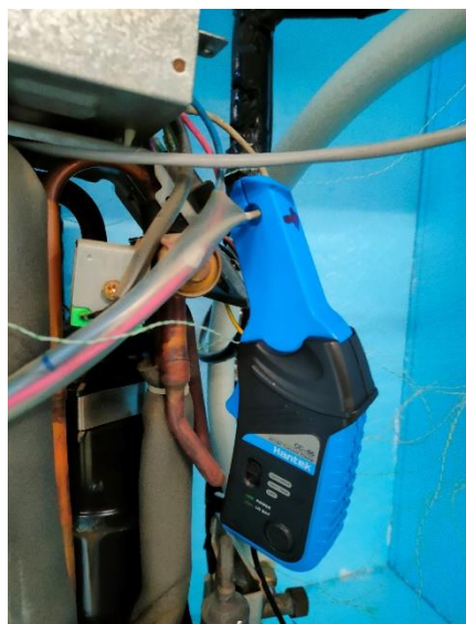
Figura 4.8 - Colocação da pinça amperimétrica
