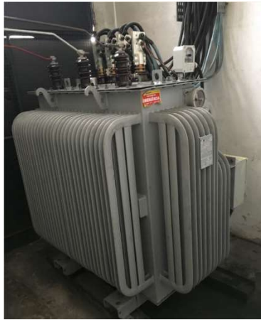
Figura 4.28 - Transformador XPTO Parafusos
