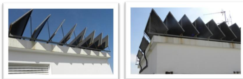
Figura 10 – Evaporadores das bombas de calor
