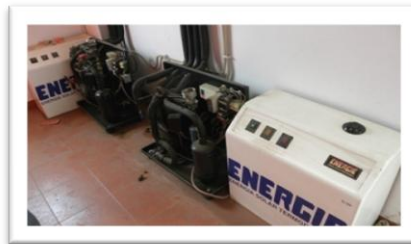
Figura 9 – Bombas de calor da Residência Masculina Ferragial
