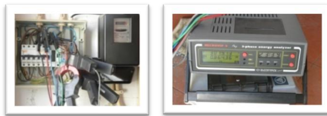
Figura 13 - Quadro eléctrico das bombas de calor com as ligações ao analisador de energia eléctrica
