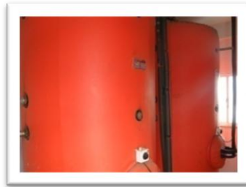
Figura 8 – Reservatórios de água das bombas de calor (reservatório 1 à esquerda e reservatório 2 à direita)
