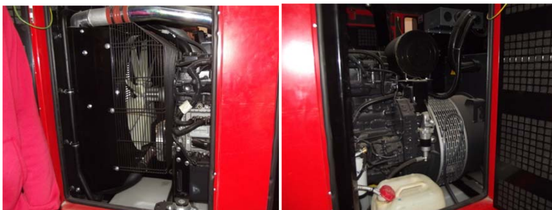
Figura 3-29 - Grupo gerador de 160 kVA.
