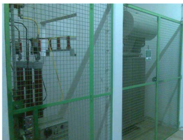
Figura 3-32 -Transformador a óleo.
