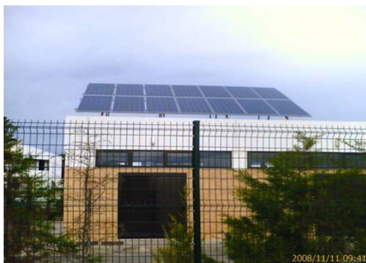
Figura 3-43 - Instalações de microgeração fotovoltaica.
