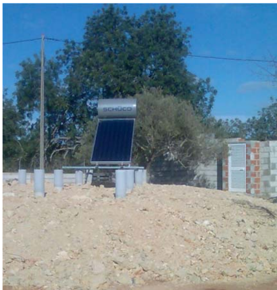
Figura 3-45 - Instalação Solar Térmica.
