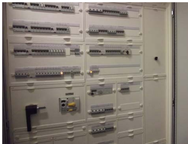
Figura 3-18 - Quadro Geral de Entrada.
