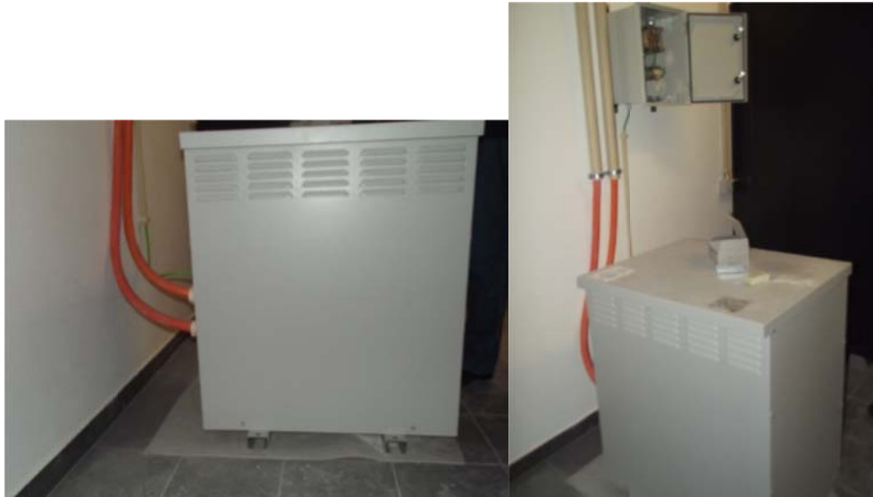
Figura 3-22 – Imagens do Transformador de Isolamento.
