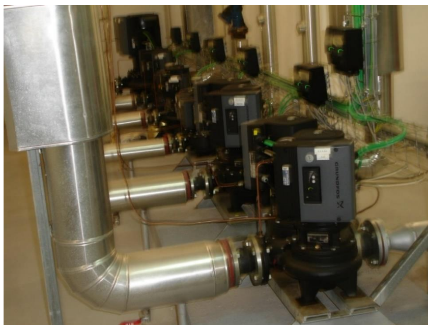
Figura 3.4 - Bombas do circuito secundário de água quente
