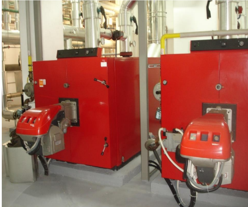
Figura 3.3 - Caldeiras da Central Térmica
