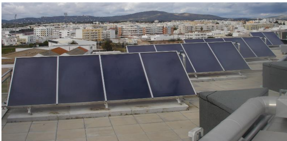
Figura 3.7 - Painel de Coletores Solares (RMH, 2014)
