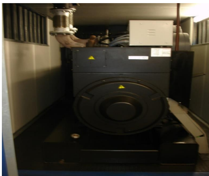
Figura 3.13 - Grupo de emergência
