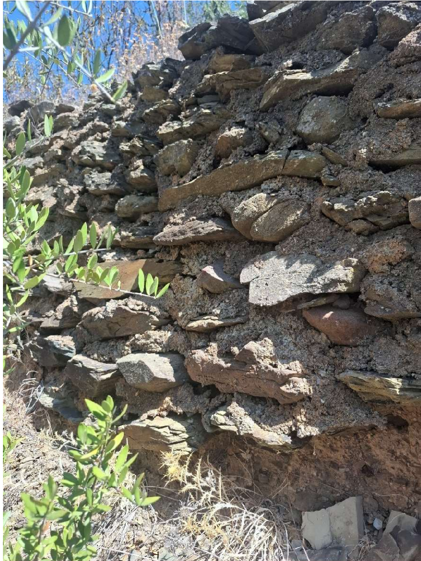
Figura 62. Existência de vazios nas juntas executadas com argamassa cimentícia, muro entre a torre 9 e a torre 3. Autoria: A. Romão 2024.
