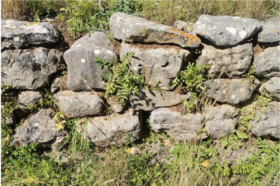
Figura 54. Pormenor da degradação das juntas do muro da primeira linha defensiva. Aatoria: A. Romão 2024.
