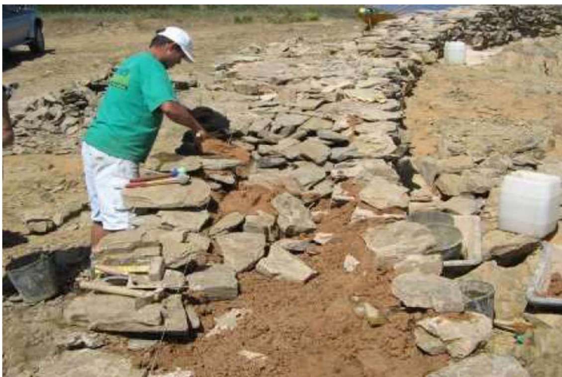
Figura 12. Pormenor dos trabalhos de conservação e restauro da estrutura delimitadora do recinto (Norte). Fonte: Braga 2008.
