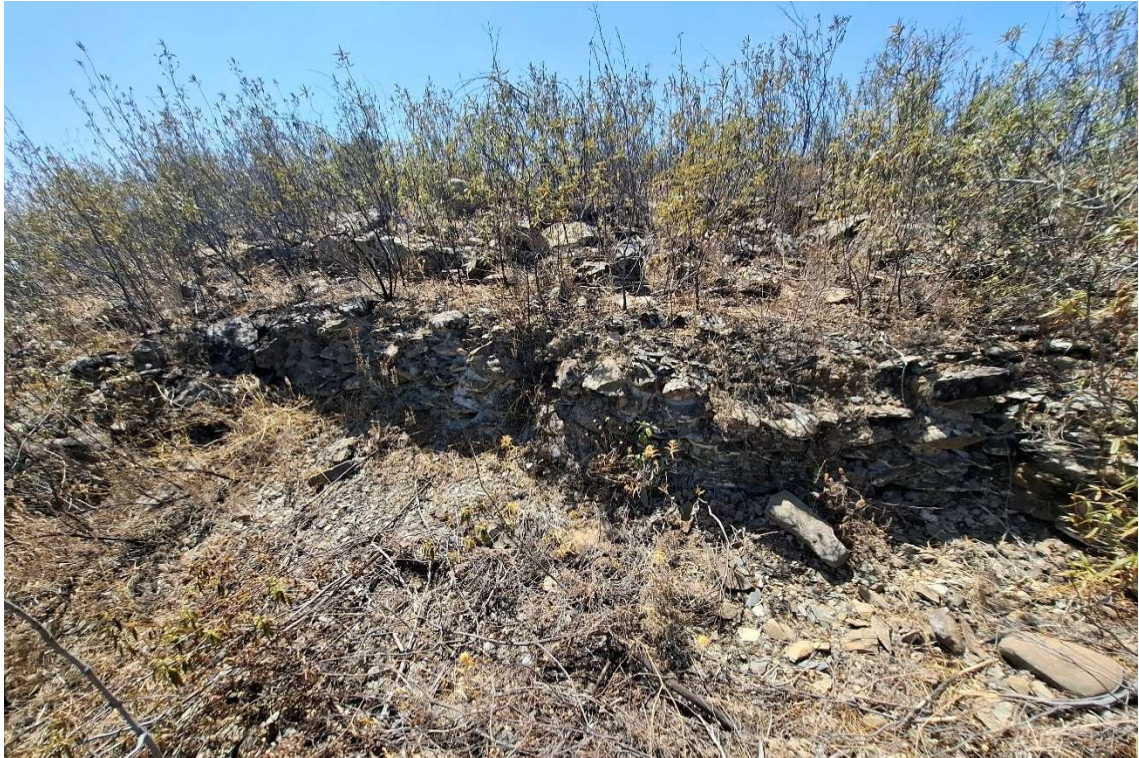
Figura 63. Pedras destacadas na estrutura torre 6. Aatoria: A. Romão 2024.
