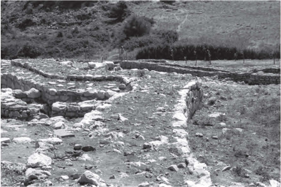
Figura 22. Vista dos trabalhos de consolidação e restauro de estruturas arqueológicas realizados em 1994, com alteamentos diferenciados consoante a cronologia relativa. Fonte: Cardoso 2022.
