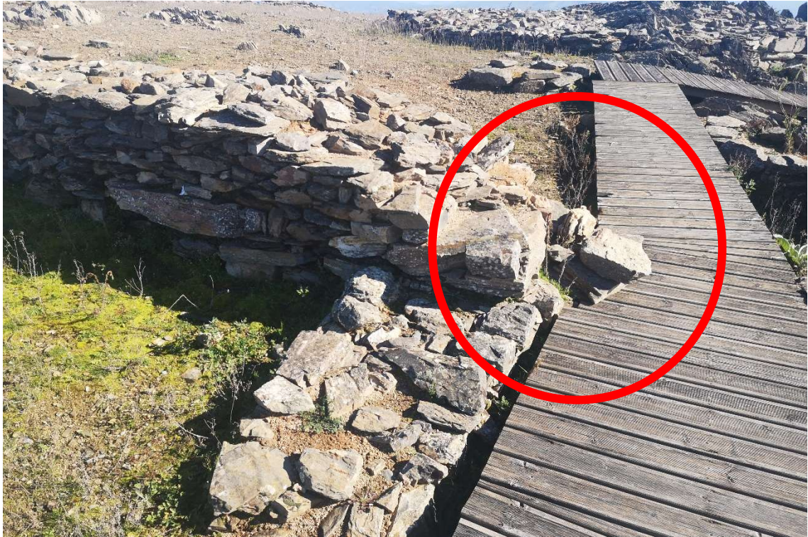
Figura 44. Derrube da extremidade do murete (m) junto à entrada oeste (W1), marcação a vermelho. A autoria: A. Romão 2024.
