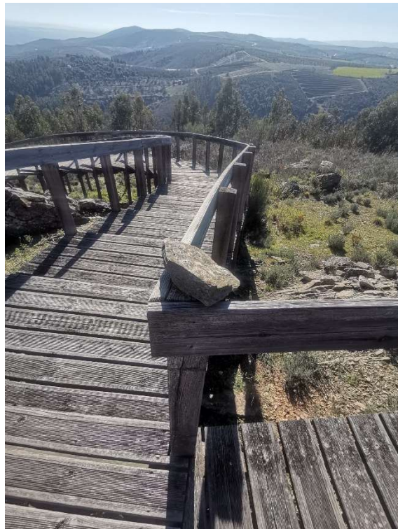
Figura 43. Existência de pedras destacadas. Aatoria: A. Romão 2024.
