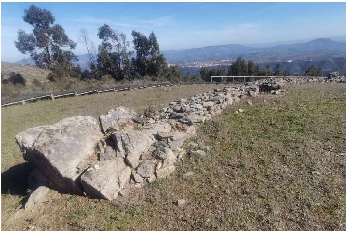
Figura 45. Crescimento de infestantes sobre a estrutura m/t – murete/talude. A autoria: A. Romão 2024.
