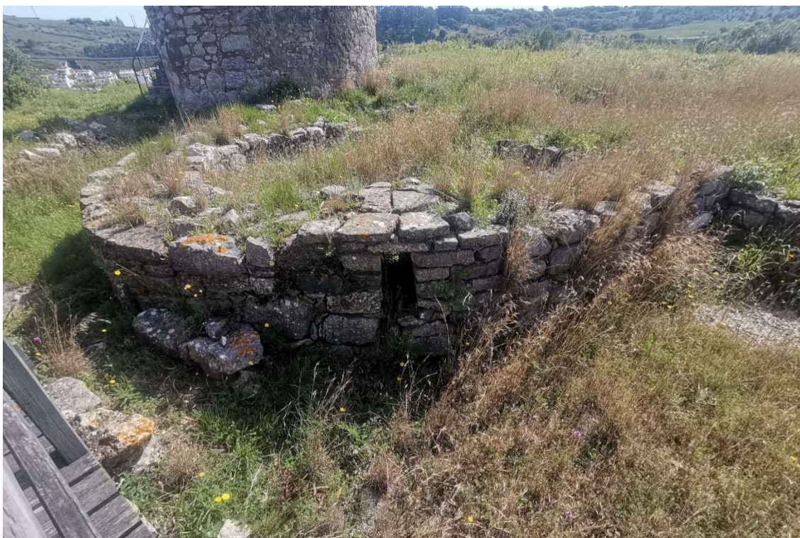
Figura 52. Vista geral da estrutura C integrada na terceira linha defensiva, onde é visível a necessidade de prover à desinfestação. Autoria: A. Romão 2024.
