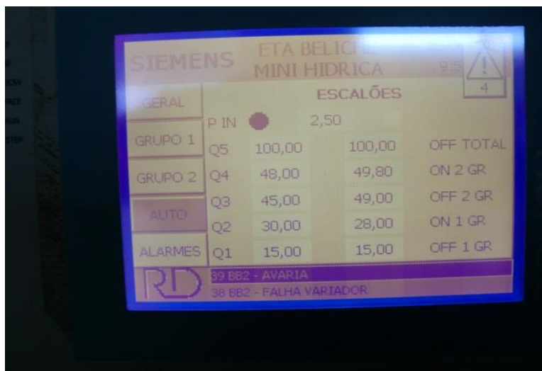
Fig.-12.1 - ETA DO BELICHE - CMH : Display de Comando e Controlo (Autómato)
