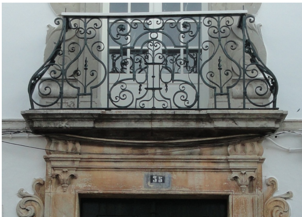
Fig.17 - O balcão da janela de sacada central, é diferente dos restantes, mas ainda recto, apresentando, no entanto, ondulação na guarda de ferro forjado.
