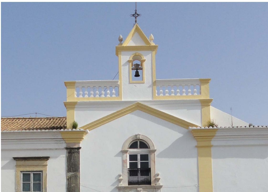
Fig. 56 -Repare-se na parte superior da fachada da ermida, concretamente na pilastra em pedra, do lado esquerdo, e na pilastra em massa, do lado direito. O recorte da cimalha que as remata são diferentes, conforme se verifica nas respectivas imagens abaixo apresentadas ( Fig. 57 e 58)
