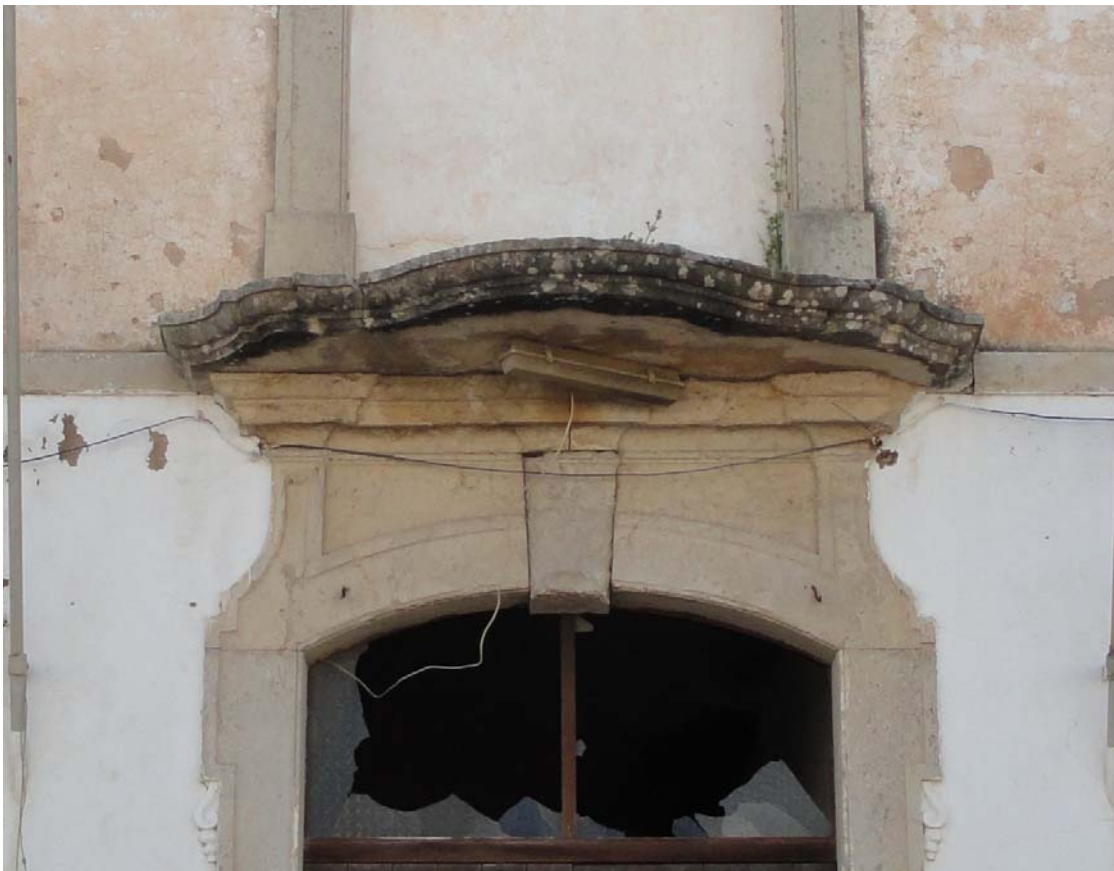
Fig.33 -O balcão da janela que encima o portal central, é mais sobressaída que as outras restantes e apresenta recorte ondulado. O portal tem verga curva, com extremos de perfil côncavo e recorte relevado.
