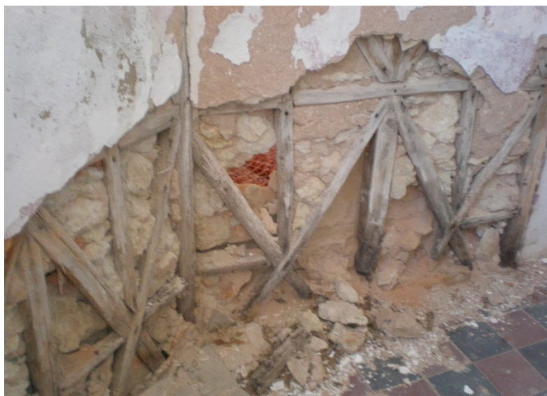
Fig.190 - Casa Azevedo e Silva – parede interior de tabique com estrutura semelhante à estrutura pombalina (gaiola).
