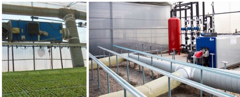
Figura 2.15 - Sistema de aquecimento a ar quente, direccionado para mangas flexíveis em polietileno perfurado debaixo das bancadas.
