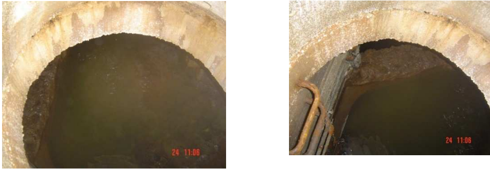
Figura 3.5 – Vista da caixa de visita onde se encontra a ligação de bypass entre os dois subsistemas de drenagem (bacia Central e bacia Nascente).
