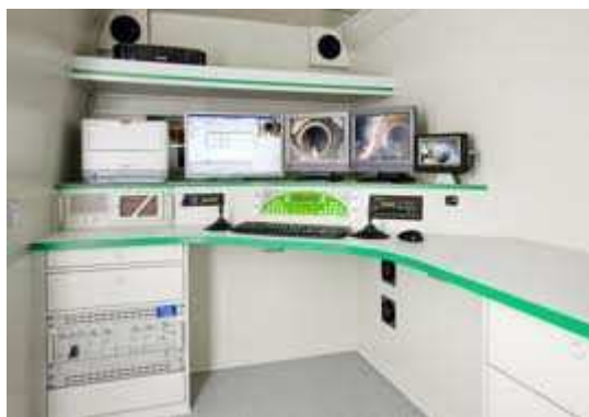
Figura 2.12 – Aspeto interior da viatura onde se instalam os equipamentos de CCTV, para inspeção de coletores.
