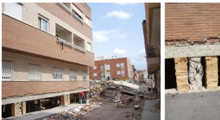
Fig. 3.24 - Pilar curto de um edifício com semicave. Sismo de Lorca (2011) (adaptado Corella, 2011).
