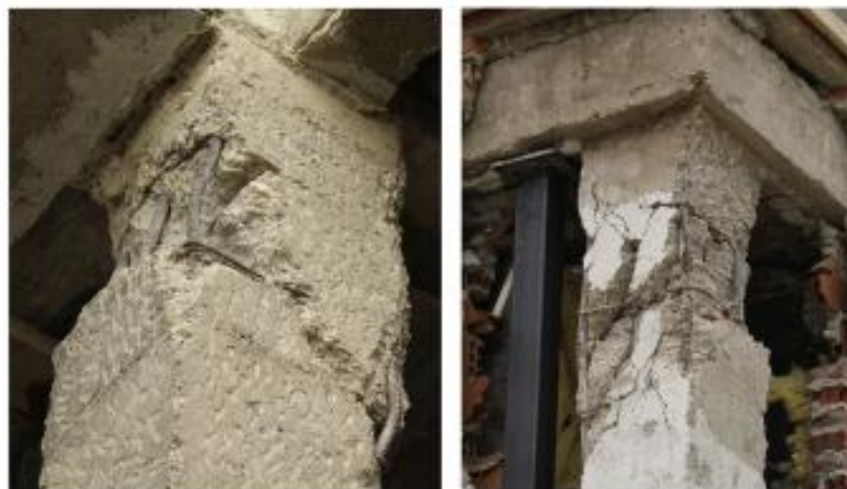
Fig. 3.23 - Rotura de pilares curtos, sismo Lorca (Romão, et al. , 2013).
