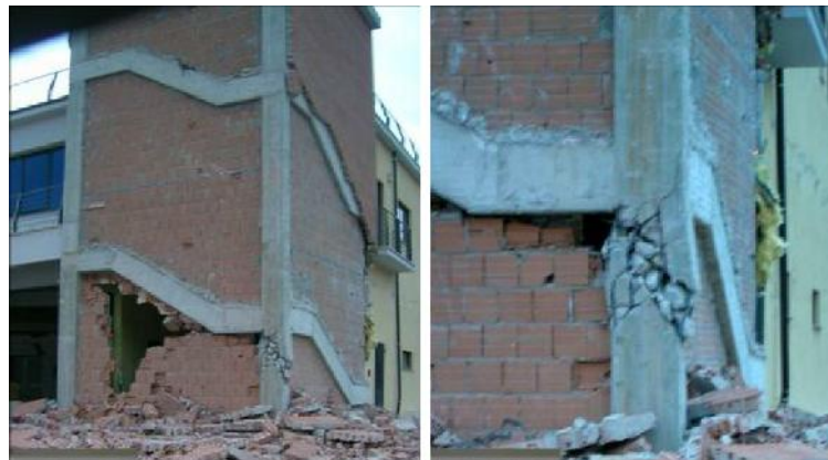
Fig. 3.22 - Rotura do pilar curto nas escadas, devido à concentração de elevados esforços nesse pilar, sismo L'Aquila (Verderame, et al. , 2009).
