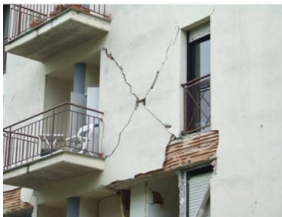
Fig. 3.13 - Fissuração nas diagonais dos painéis, sismo de L'Aquila (2009) (Braga, et al. , 2010).
