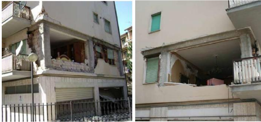
Fig. 3.16 - A falta de confinamento entre paredes de alvenaria e a estrutura de betão armado, origina a projeção parcial dos panos de alvenaria ou a projeção total destes. Sismo de L'Aquila (2009) (Verderame, et al. , 2009).
