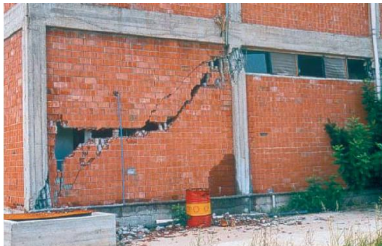
Fig. 3.30 - Esmagamento dos pilares nos cantos do painel de alvenaria provocado pela transmissão de forças provenientes da alvenaria (Bachmann, 2003).
