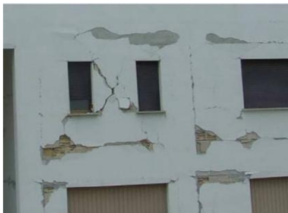
Fig. 3.11 - Esmagamento das unidades de alvenaria nos cantos dos painéis de alvenaria, sismo de L'Aquila (2009) (Braga, et al. , 2010).
