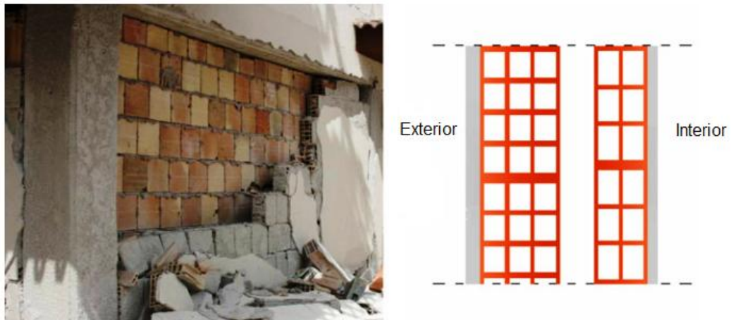
Fig. 3.17 - Projeção parcial dos panos de alvenaria, sismo de L'Aquila (2009) (Braga, et al. , 2010).
