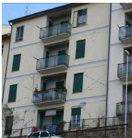
Fig. 3.14 - Fissuração nas diagonais dos painéis em diversos pisos, sismo L'Aquila (2009) (Verderame, et al. , 2009).
