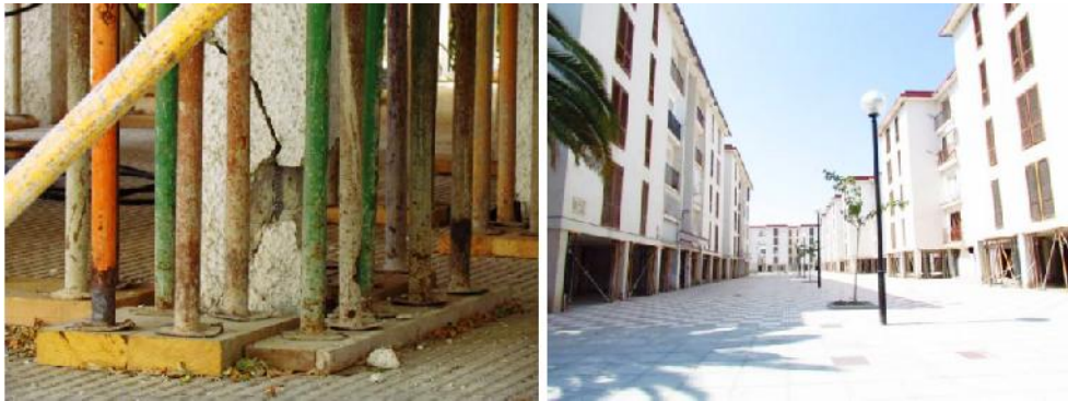
Fig. 3.21 - Edifícios com pisos vazados, rotura dos pilares do piso térreo, fenómeno provocado pela irregularidade em altura dos edifícios, sismo Lorca (Regalado e Lloret).
