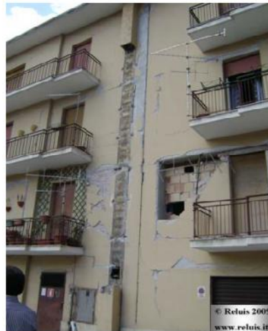
Fig. 3.10 - Projeção total e parcial das unidades de alvenaria no canto do painel de alvenaria do primeiro piso, sismo de L'Aquila (2009) (Verderame, et al. , 2009).
