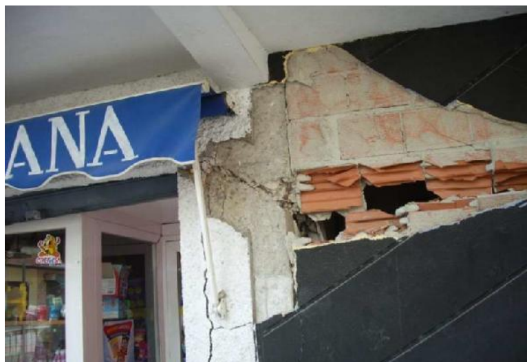
Fig. 3.19 - Esmagamento do canto do painel da alvenaria com projeção de alguns fragmentos das unidades de alvenaria e rotura do elemento de betão armado (Corella, 2011).
