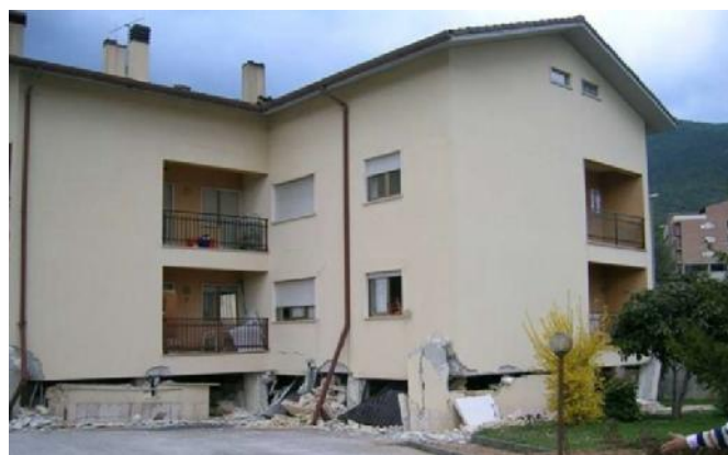
Fig. 3.20 - Rotura total dos pilares, devido ao mecanismo de piso ou soft storey, (acontece em pisos vazados), sismo de L'Aquila (Verderame, et al. , 2009).
