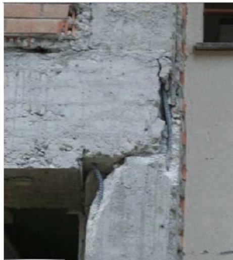
Fig. 3.25 - Danos na ligação pilar-viga, sismo de L'Aquila (2009) (Verderame, et al. , 2009).
