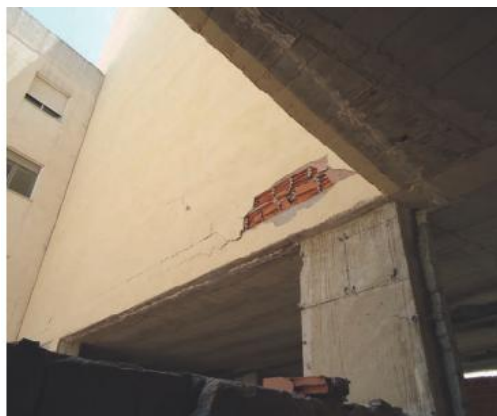
Fig. 3.12 - Esmagamento do canto do painel de alvenaria de enchimento, sismo de Lorca (2011) (Cabal, 2013).
