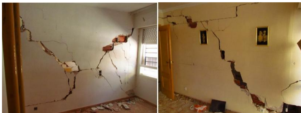
Fig. 3.15 - Fissuração nas diagonais dos painéis de alvenaria, vista do interior de uma habitação, sismo de Lorca (2011) (Regalado e Lloret).
