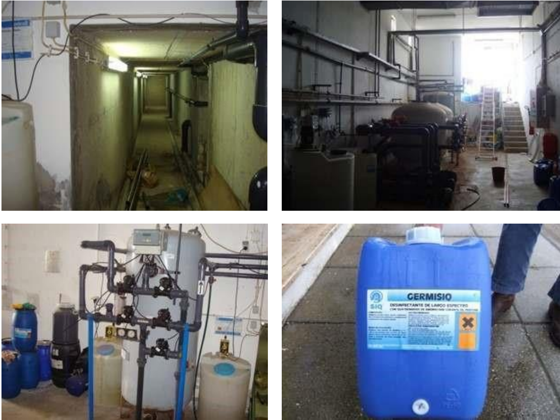
Figura 7.19 – Fotos de sistemas técnicos da central térmica.
