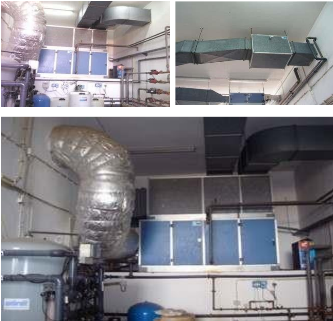
Figura 7.17 – Fotos de ventilação e climatização.
