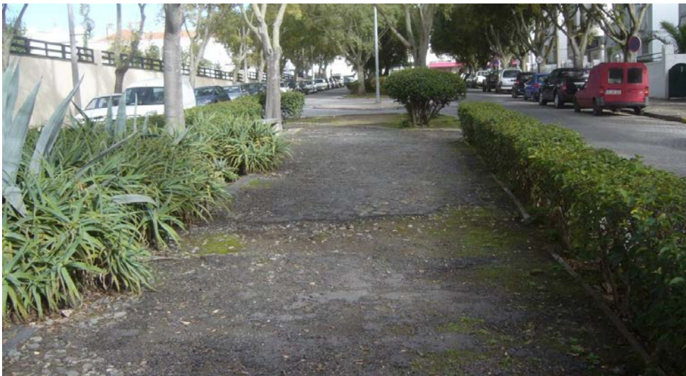
Figura 90 - Fotografia da zona de circulação, com pavimento degradado
