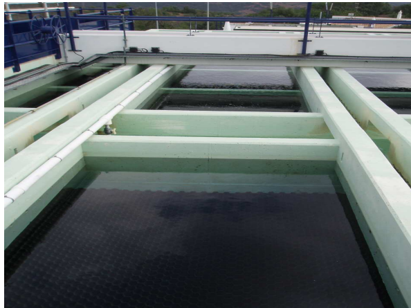
Figura 12 – Decantadores do tipo “PULSATOR LAMELAR” da ETA de Tavira.
