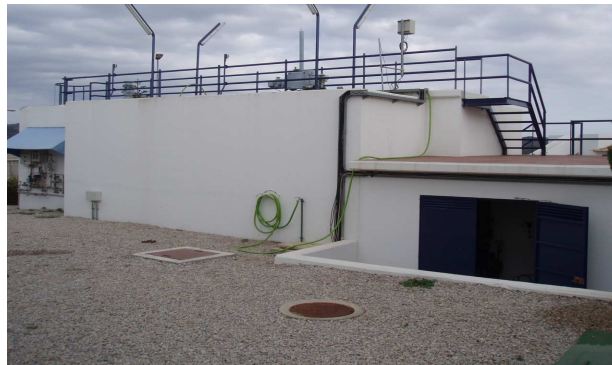
Figura 15 – Vista exterior do órgão Densadeg da ETA de Tavira.
