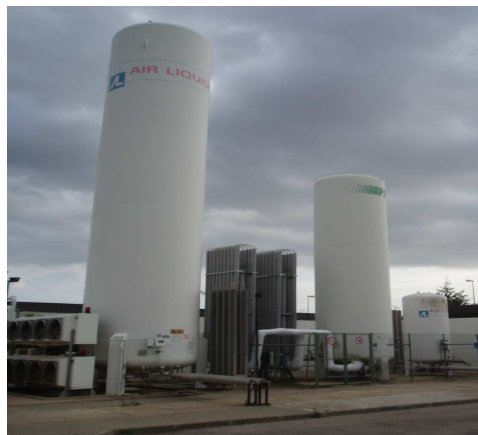
Figura 11 – Reservatórios do oxigénio, azoto e dióxido de carbono da ETA de Tavira.
