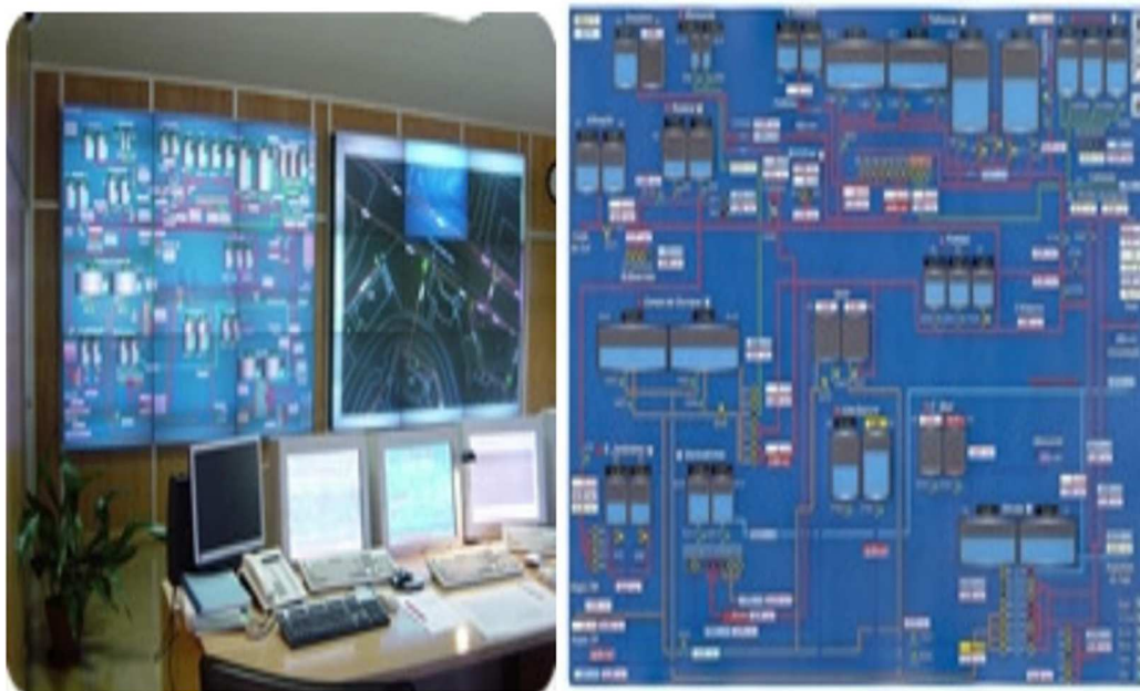
Figura 3-6 - Centro de comando e layout da supervisão [6]
