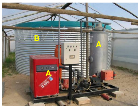
Figura 4 – Caldeiras (A) e tanque de armazenamento de água aquecida (B)
