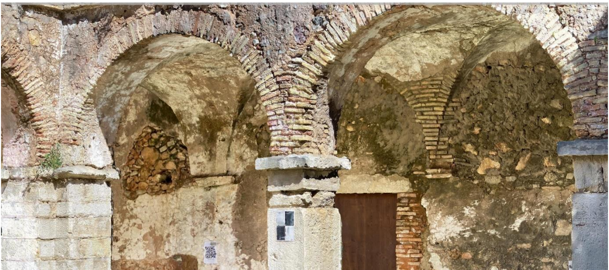
Figura 32 - Vista do modelo 3D, pormenor do pilar e arcada. (foto do autor)
