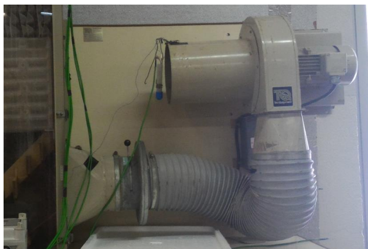
Figura 8 - Ventilador da Torre de Arrefecimento
