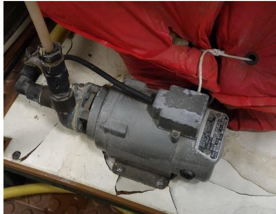
Figura 5 - Bomba circuladora da torre de arrefecimento
