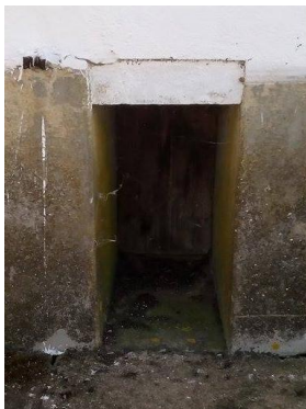
Figura 4.48- Pormenor da entrada/ saída.
