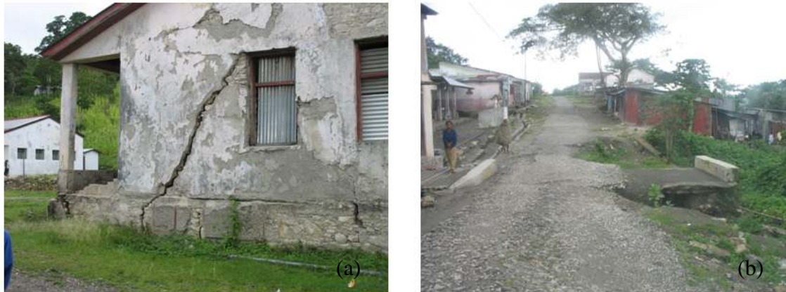
Figura 43 – Prejuízos causados pelos movimentos de vertente na área de estudo, Vila de Bobonaro. (a) As instalações da antiga Companhia de Cavalaria Nº 5 de Bobonaro, (b) Via principal da Vila de Bobonaro. (Foto registada em 2008).
