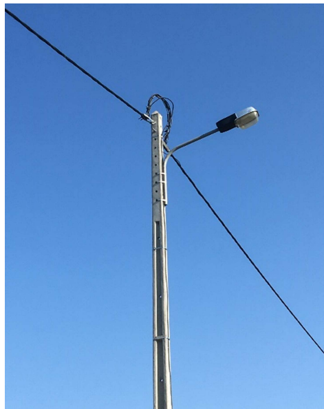
Figura 4.1 – Exemplo de luminária instalada em apoio de rede aérea
