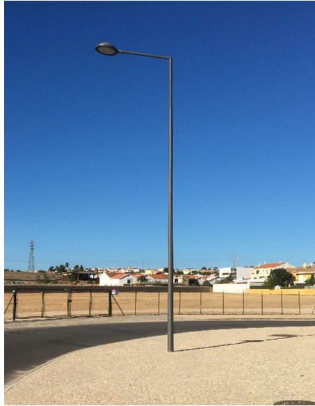
Figura 4.2 - Exemplo de luminária instalada em coluna
