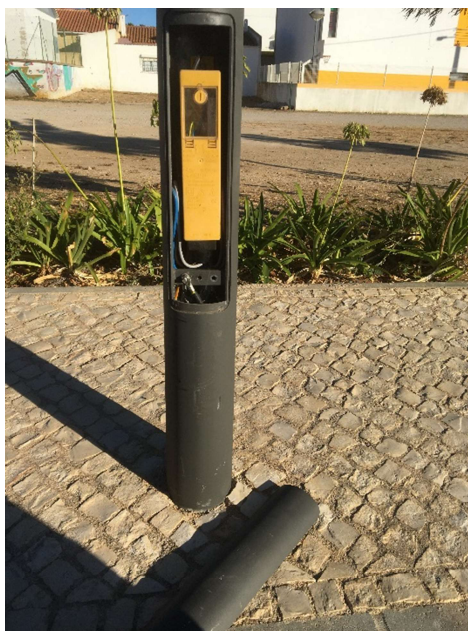
Figura 4.3 – Quadro elétrico em coluna de IP
