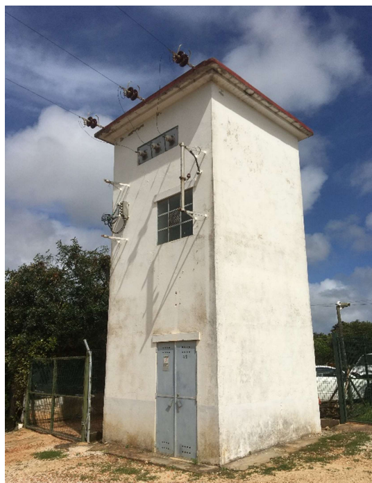
Figura 3.4 – Exemplo de PT em cabina alta
