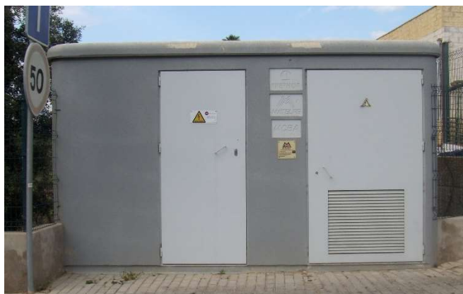
Figura 3.9 – Exemplo de PT em cabina baixa pré-fabricada em betão armado
