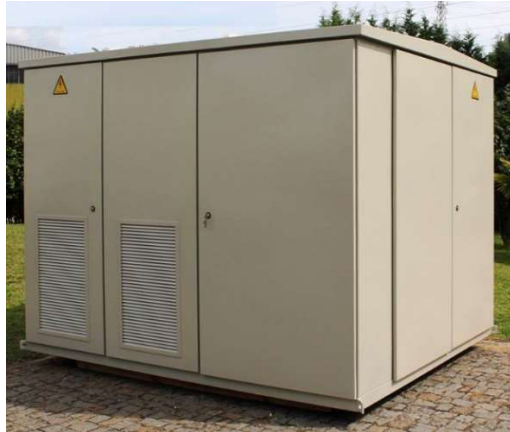
Figura 3.10 – Exemplo de PT em cabina pré-fabricada com invólucro metálico [13]
