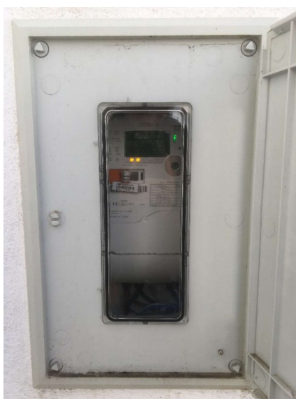
Figura 3.35 – Exemplo de caixa de contagem
