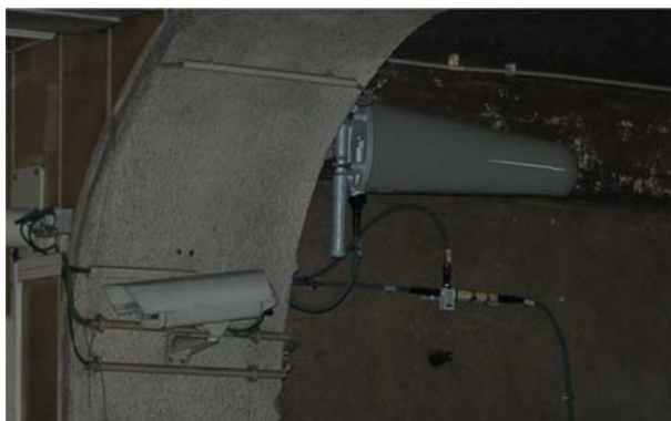
Figura 2.11 - Antena Logarítmica Periódica (Kathrein) instalada na estação de Picoas [20]
