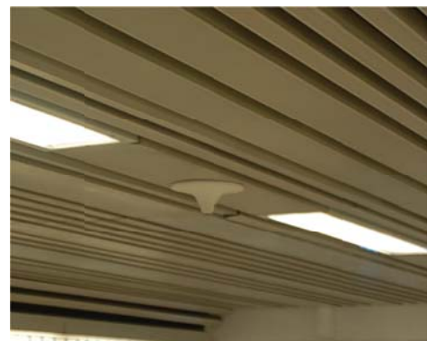
Figura 2.12 - Antena Interior Omnidirecional (Kathrein) instalada na estação de Picoas [20]
