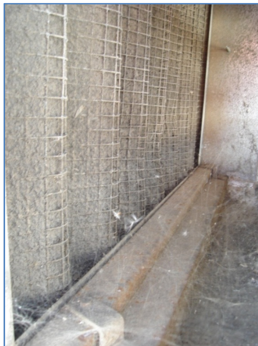
Figura 31 - filtro unidade insuflação de ar novo, auditório 0.04
