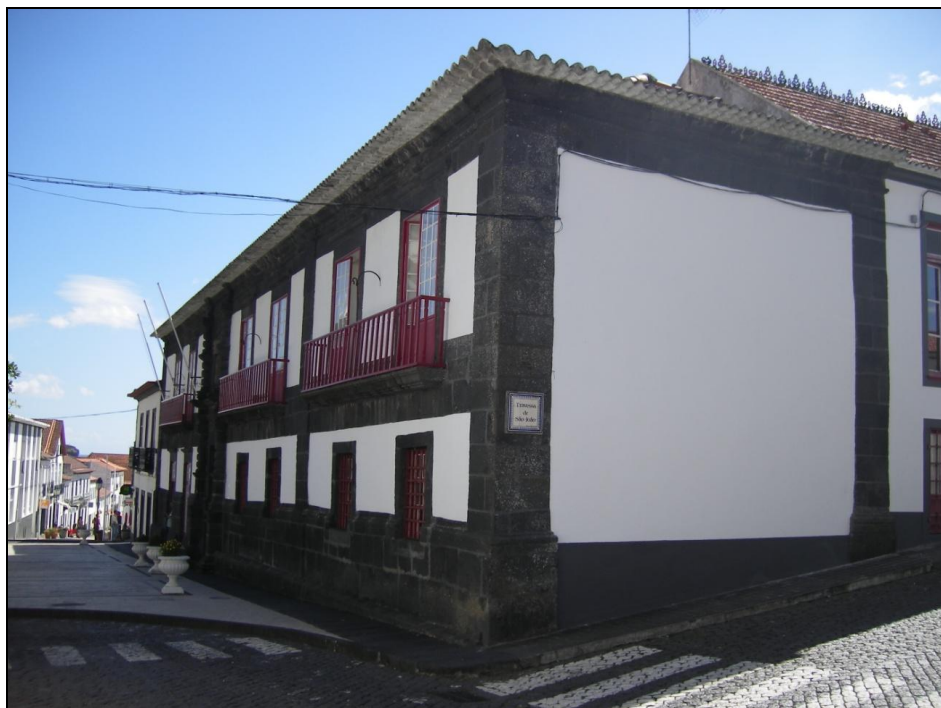
FIG. 123 – Casa de câmara e cadeia das Velas – perspectiva do cunhal da fachada principal com o alçado lateral norte.
