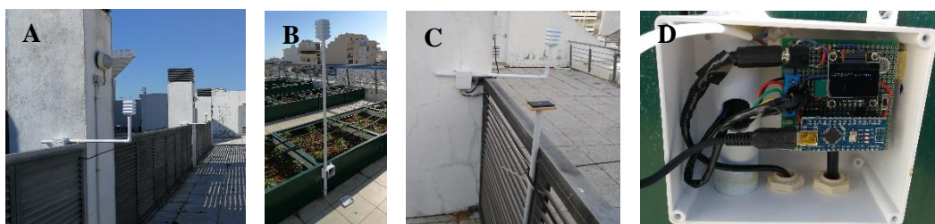
Figura 2.6 - Instalação das estações meteorológicas. A - Zona lateral sem floreiras; B - Zona com floreiras; C – Estação com célula solar fotovoltaica; D - Pormenor do interior da estação.
