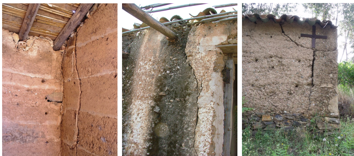
Figura 3. Fissuração de origem estrutural em paredes.
