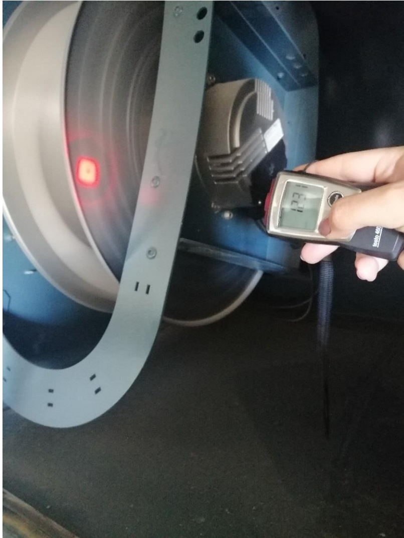
Figura 0.18 – Medição de R.P.M de ventilador
