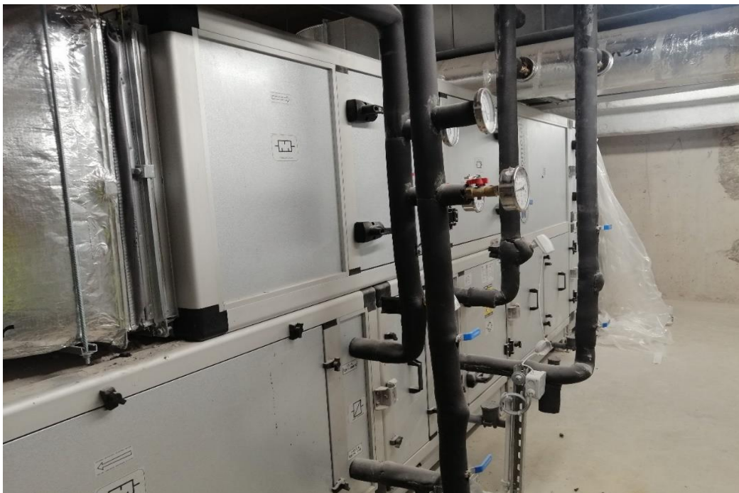
Figura 0.17 – Unidade de tratamento de ar – Central Bloco A
