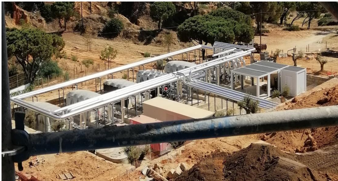
Figura 0.15 – Central térmica – Central Exterior
