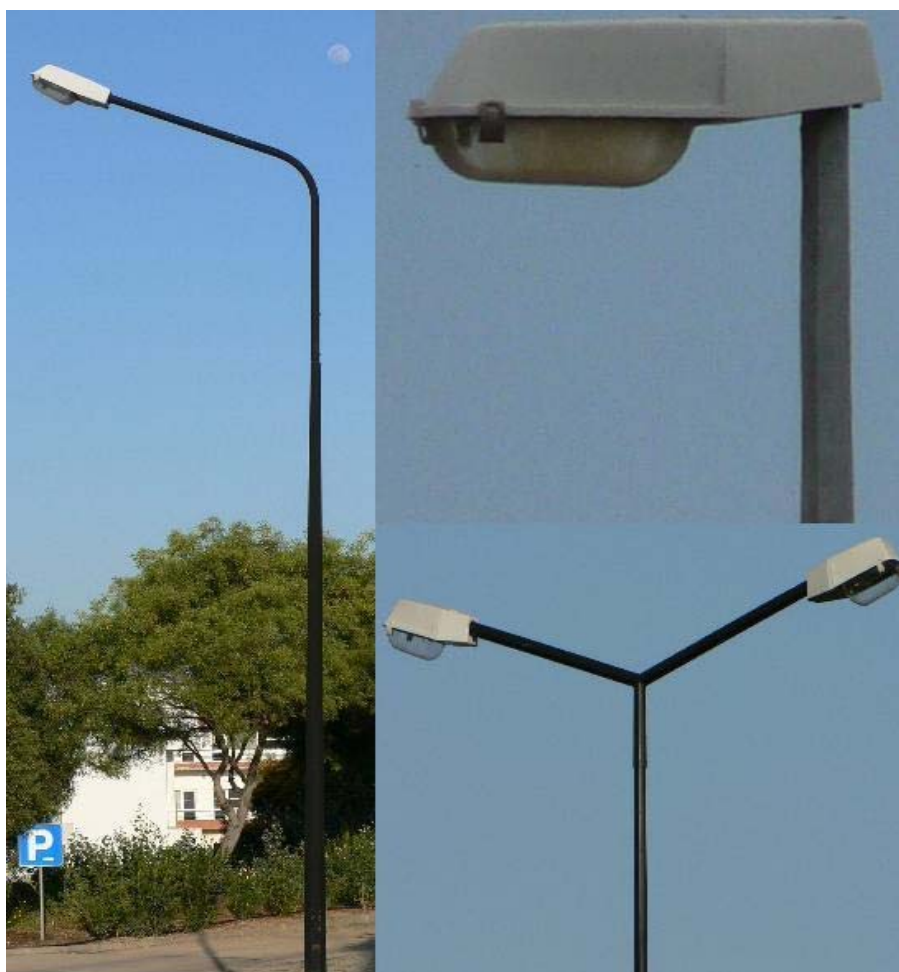
Fig. 2. 6 - Colunas de iluminação de 8 m em ambos os Campi .
