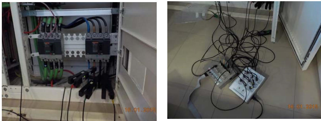
Fig. 4.3 – Equipamento instalado no quadro elétrico.
