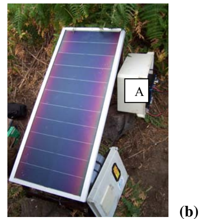
Figura 6 - Caixa protectora do receptor (A), bateria (B), painel solar (C) e suporte (D) montado na área de estudo.
