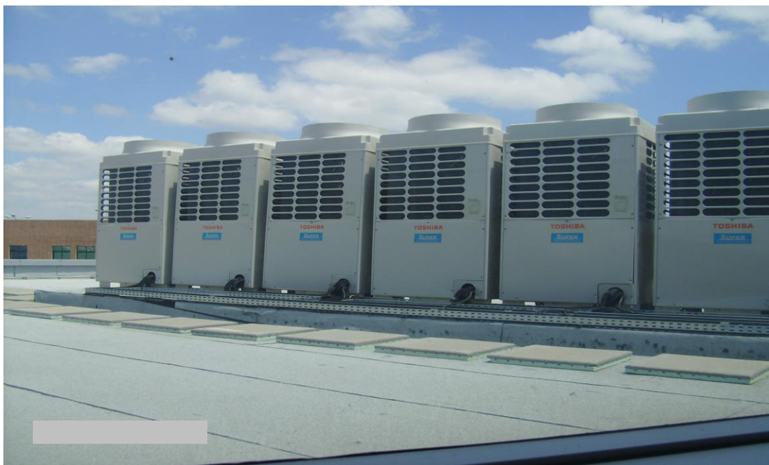
Figura 10 – Zona técnica de AVAC
