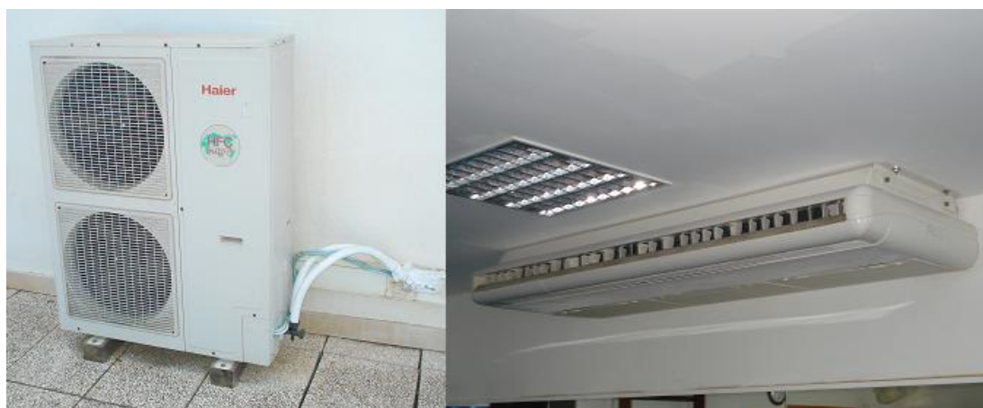
Figura 41 – Unidade de climatização, exterior e interior, da sala de fitness .
