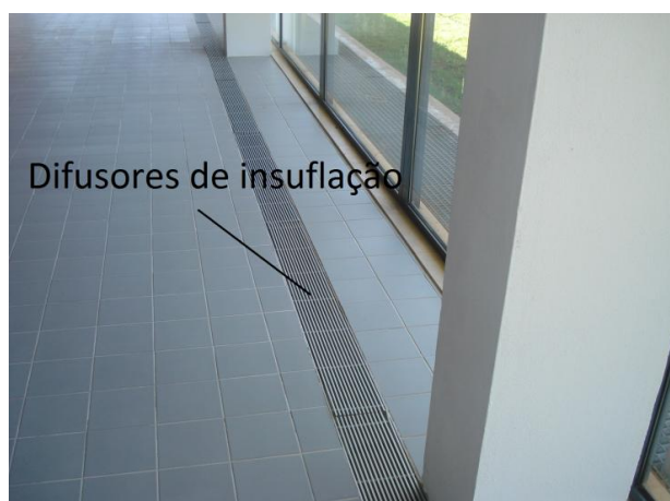
Figura 28 – Difusores de insuflação de ar situados no solo da nave da piscina.
