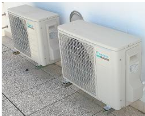
Figura 42 – Unidades exteriores de climatização tipo bomba de calor da daikin .
