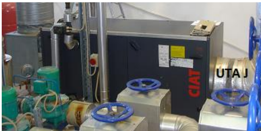
Figura 45 – Unidade de tratamento de ar instalada na sala técnica (UTA J).
