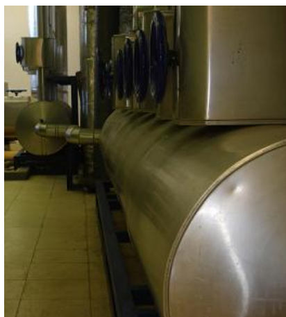
Figura 15 – Coletores de ida e retorno de distribuição das águas quentes.
