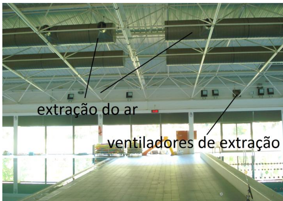
Figura 29 – Conduitas de extração do ar da nave para retorno às UTA'S e ventiladores helicoidais de extração e rejeição de ar da nave.
