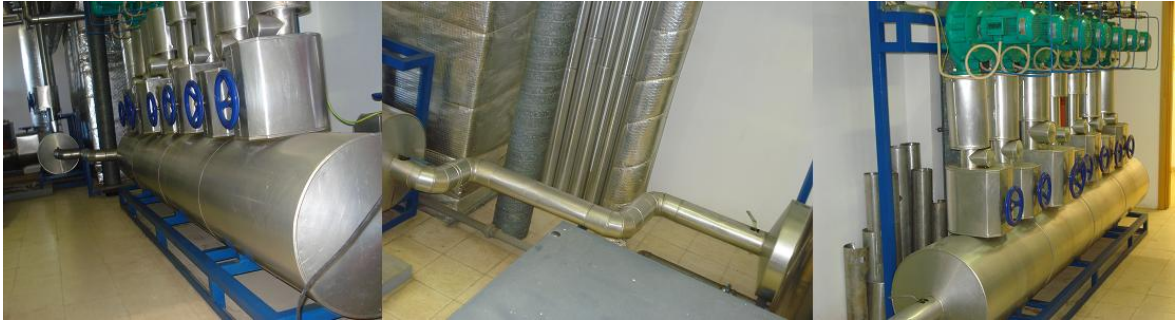
Figura 34 – Depósitos de retorno, ida e bombas de recirculação.
