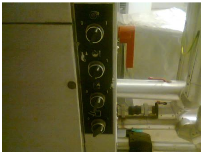
Figura 36 – Painel de controlo das desumidificadoras instaladas no piso -1.
