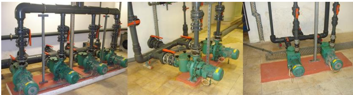
Figura 31 – Bombas de circulação da piscina desportiva, de aprendizagem e chapinheiro (da esquerda para a direita).
