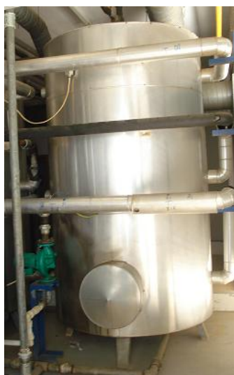
Figura 14 – Depósito de inercia com 3600 litros instalado na sala técnica, com temperatura de acumulação de 60 °C (2 unidades).
