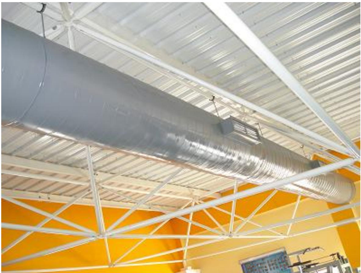
Fotografia 39 – Conduto de insuflação do ginásio.
