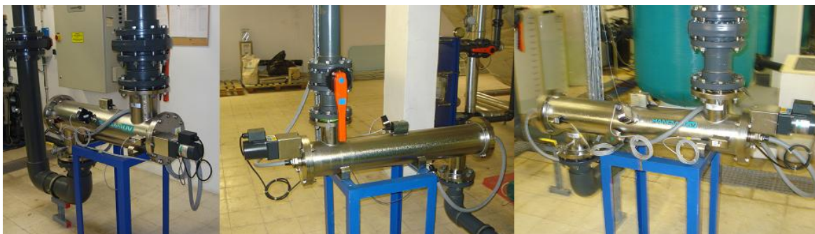
Figura 33 – Ultravioletas da piscina desportiva, chapinheiro e de aprendizagem (da esquerda para a direita).
