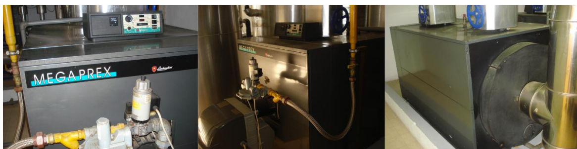
Figura 35 – Caldeiras MEGAPREX para AQS e climatização localizadas na sala técnica do piso 0.
