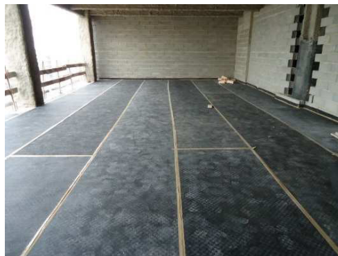
Figura 19 - Isolamento Acústico a sons de Percussão
