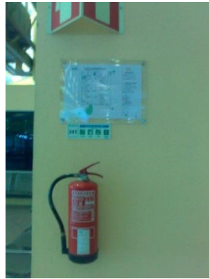
Figura 2. Extintor no sector de trabalho
