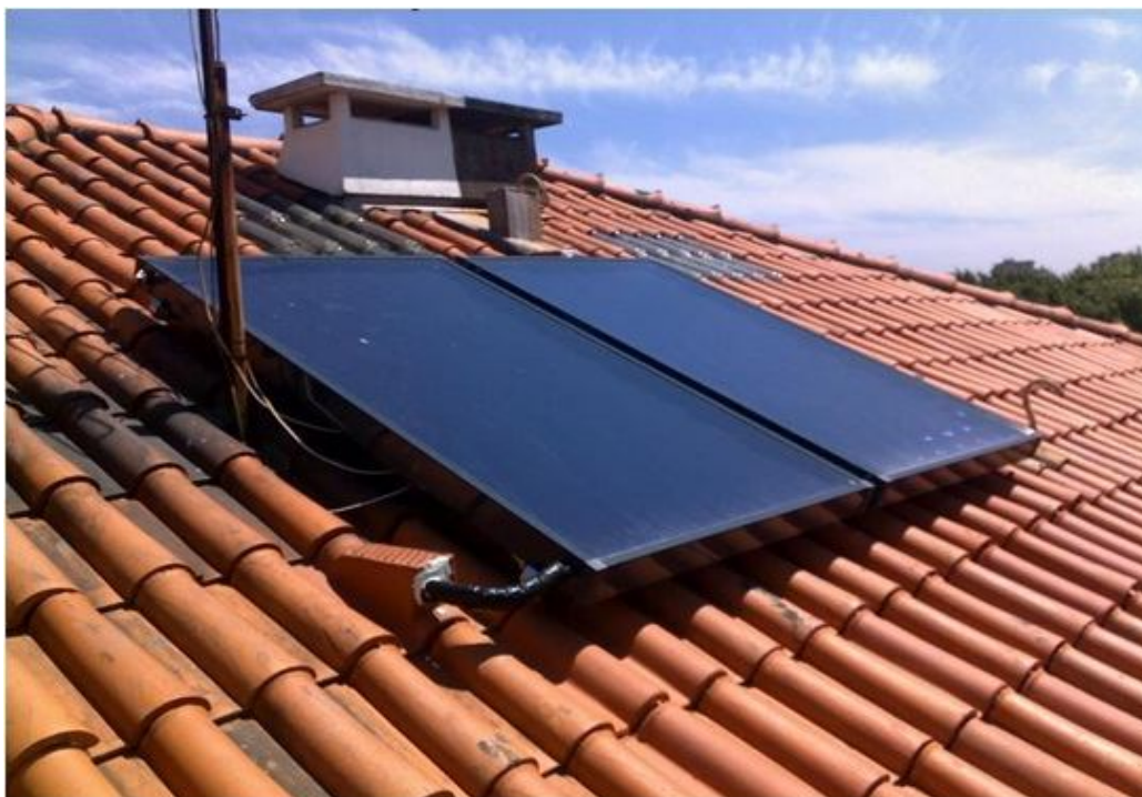
Instalação de Sistema de Circulação Forçada 300L no Porto
