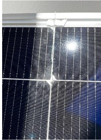
Figura 37 - Termopar de medição da temperatura no topo da superfície de incidência solar do painel fotovoltaico
