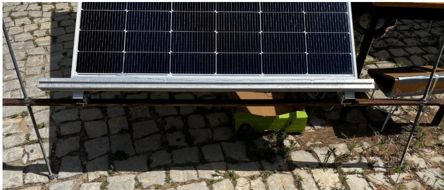
Figura 31 - Sistema de regulação de inclinação da estrutura suporte do painel fotovoltaico
