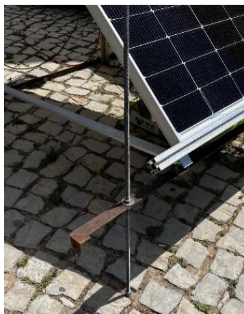
Figura 30 - Sistema de regulação de inclinação da estrutura suporte do painel fotovoltaico
