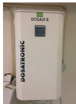
Figura 4.7 – Sistema doseador de dióxido de cloro
