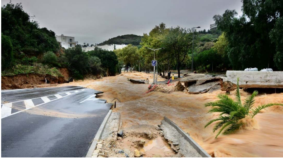
Figura 9: Troço de estrada da Avenida da Liberdade destruído pela enxurrada de 01/11/2015, Albufeira.
