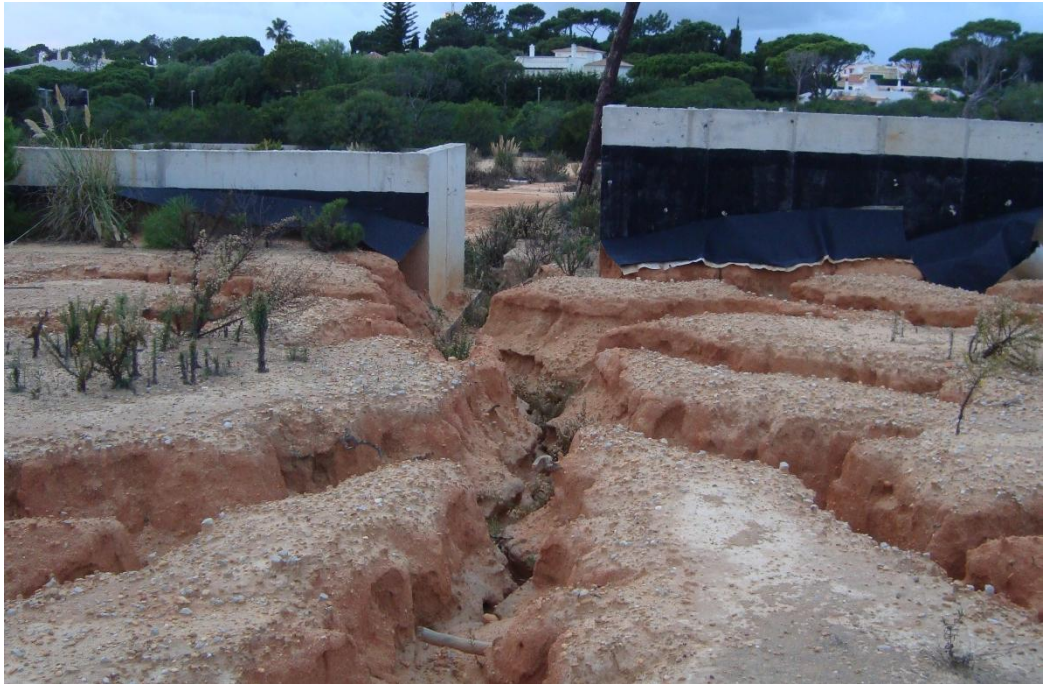
Figura 68 – Ravinamento observável na área do loteamento.
