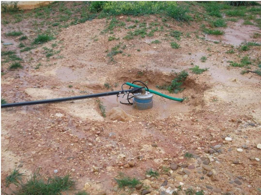
Figura 52 – Pormenor do sistema de bombagem responsável pela circulação de água.
