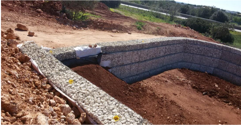
Figura 122 – Ensaio para definição da inclinação final do talude da bacia de retenção 1. É possível observar o revestimento com manta geotêxtil e tela PEAD, assim como os negativos que servirão para colocação da vedação metálica.
