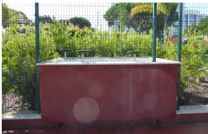
Figura 88 – Volantes de manobra das válvulas da bacia enterrada sob o campo de ténis.
