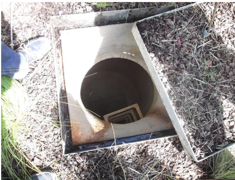
Figura 90 – Câmara de visita de uma das bacias de retenção.
