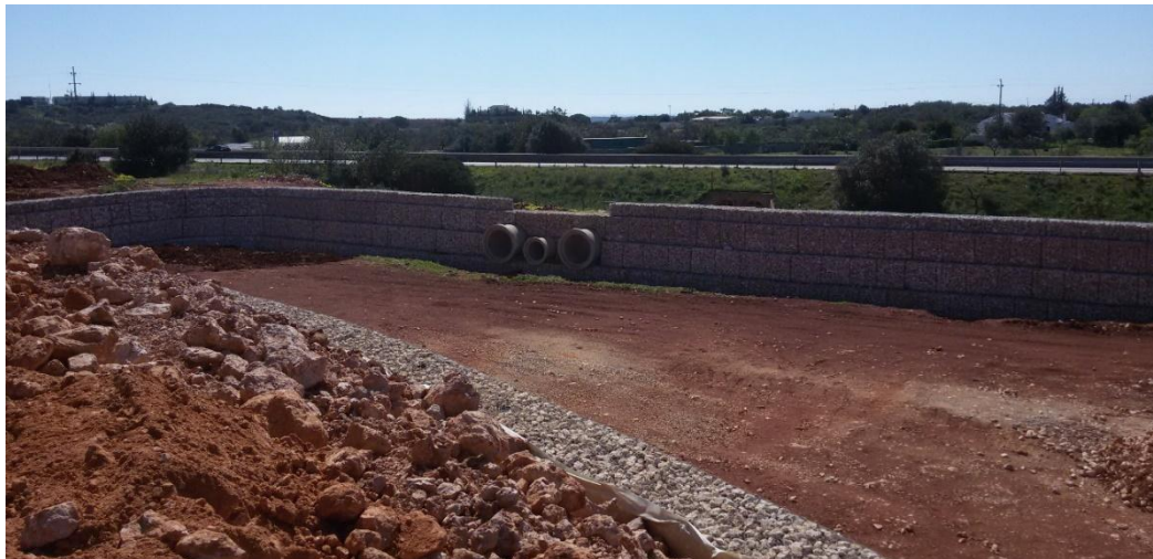
Figura 120 – Aspeto geral da bacia de retenção 1 com a cota de soleira ainda por atingir. Vista de Poente.
