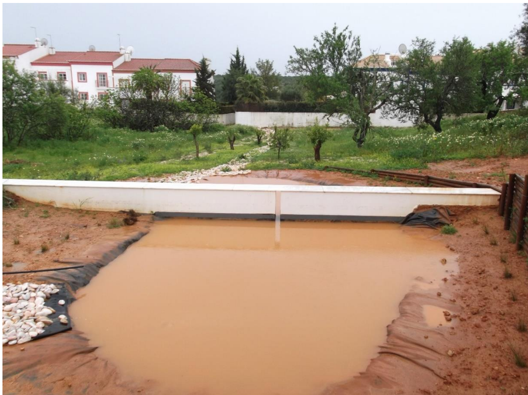
Figura 50 – Vista da bacia de retenção mais a jusante do sistema.
